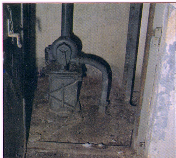
Il sistema di ventilazione alla base di una torretta GFM modello A.
