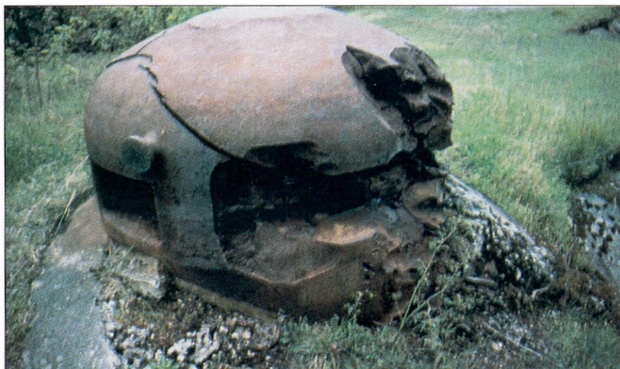
Torretta GFM tipo A mod. 1929 della piccola opera di Kerfent, danneggiata da proiettili da 88 mm.
